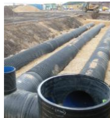
Vasche di laminazione interrate
